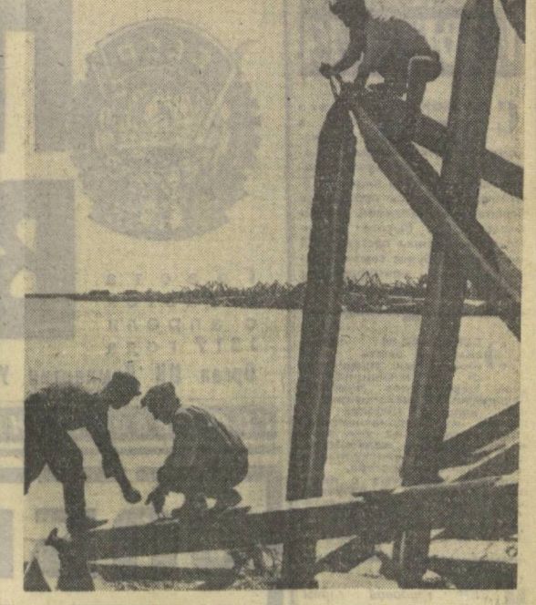
Только так, противопоставив воде железобетонные конструкции, можно остановить разрушительное действие деижа на Аму-Дарье, в результате которого новарная река, меняя русло, метр за метром булавало «сдаст» берега. Бригада Матлуба Нурметова из Янгинабадского СМУ, производящего эту работу, систематически выполняет задание на строительстве противодеижных укреплений.
