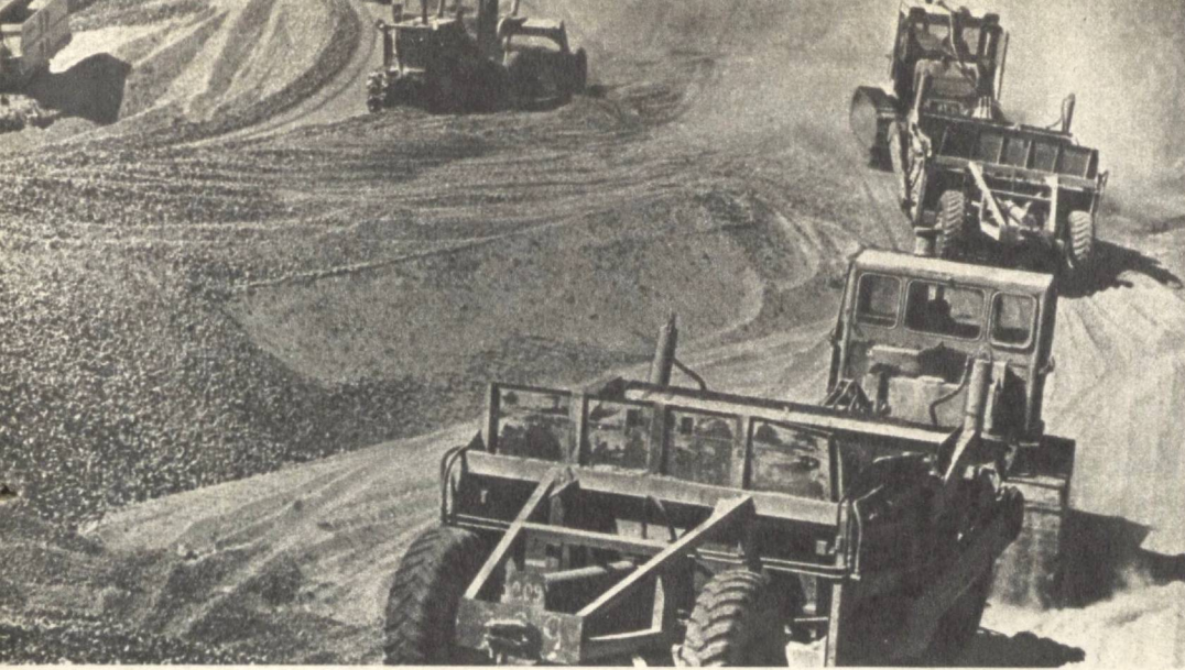
Болдир — Оқтош — Хўжайкон темир йўли шохобчасининг бир қисми тоғлик жойдан ўтади. Йўл очишда қудратли техника инсонга хизмат қилмоқда.
