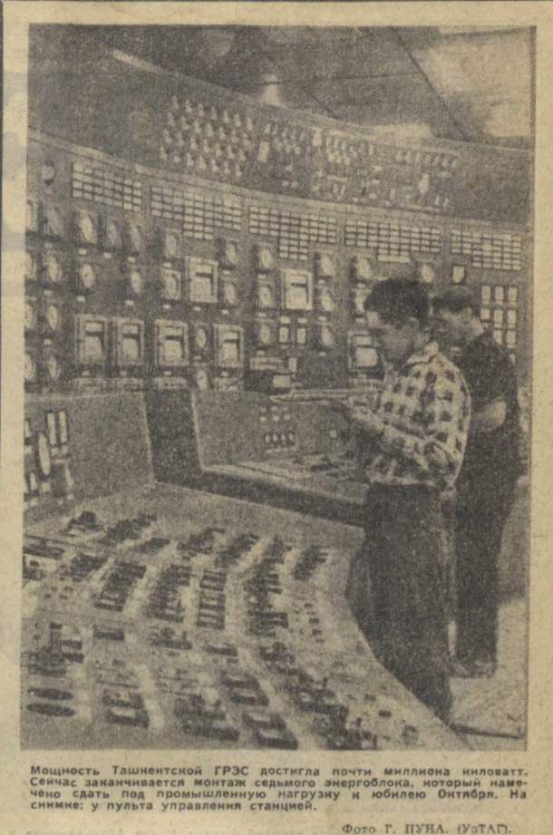
Мощность Ташкентской ГРЭС достигла почти миллиона киловатт. Сейчас заканчивается монтаж седьмого энергоблока, который наведет на станцию под промышленную нагрузку и юбилей Октября. На снимке: у пульта управления станцией.
