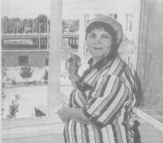
4-таъмирлаш-қурилиш бошқармасининг бўёқчиси Гўзал Харисова чорак асрдан буён қурилишда меҳнат қилади. Шу кунларда у Собир Раҳимов туманидаги 1-юкумли касалликлар шифохонасидаги таъмирлаш ишларида фаоллик кўрсатиб ишламоқда.
