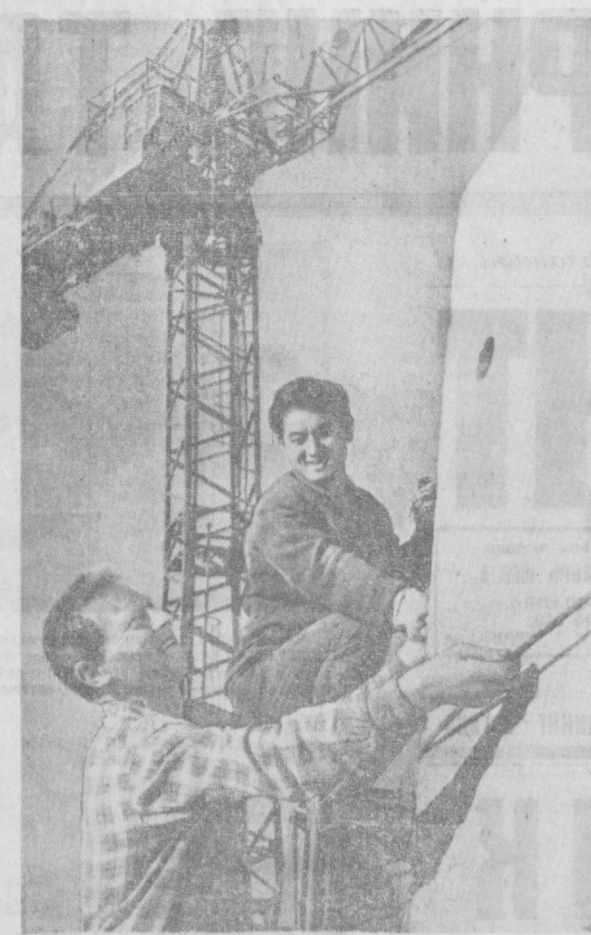
Тошкент уйсозли комбинатининг иурувчи монтажчилари Чинзор масшидаги «4» микрорайонда 120 квартиралар уй-жой биносини тикламоқдалар. Суратаа: моҳир монтажчилардан Александр Ашиқини ва Михаил Ма. металев уртоқлар иш устида. В. Сиротнини фотоси.
