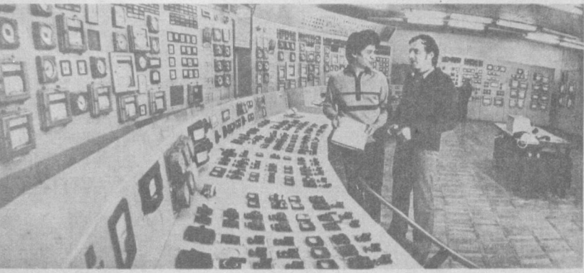
Тошкент ГРЭСининг ишчи ва хизматчилари КПСС XXVII съезди шарафига бошланган социалistik мусобақада фаол иштирок этиб, ишлаб чиқаришни тақийишларини, ресурсларини тежаш борасида катта ютуқларни қўлга киритишмоқда. Уларнинг саховатли меҳнати туғайли
