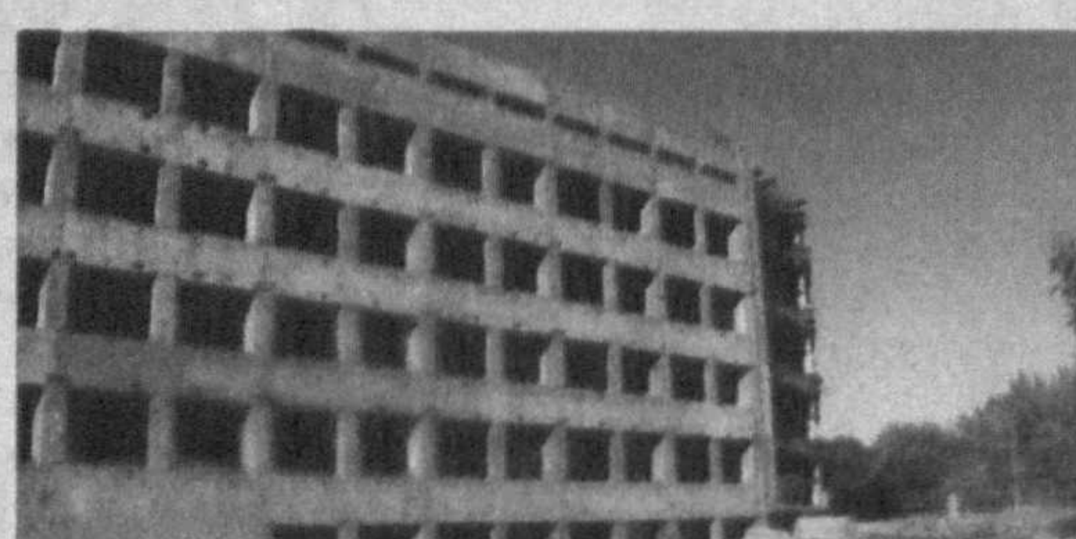
Тошкент шаҳри, Мирзо Улуғбек тумани, Феруз даҳасида жойлашган қурилиши тугалланмаган поликлиника биноси. Бошланғич баҳоси — 632 401,07 АҚШ доллари.
