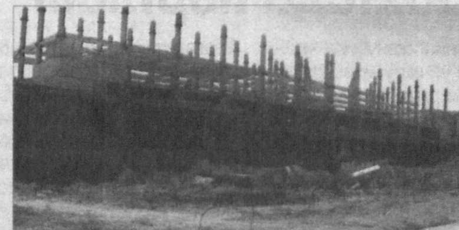
Тошкент шаҳри, Ҳамза тумани, Галабининг 40 йиллиги мавзеси, 1-даҳасида жойлашган қурилиши тугалланмаган поликлиника биноси. Бошланғич баҳоси — 432 220,00 АҚШ доллари.
