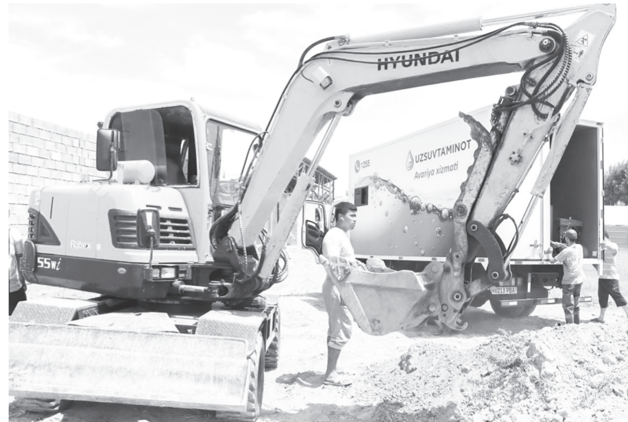
Сув таъминоти бўйича бошланган хайрли ишлар тез орада электр, табиий газ, йўл соҳасида давом этиши режалаштирилган. Бу маҳаллада истиқомат қилувчи аҳоли турмуш шароитини янада яхшилаб, уларнинг бугунги кунидан миннатдор бўлиб яшашларига сабаб бўлади.
