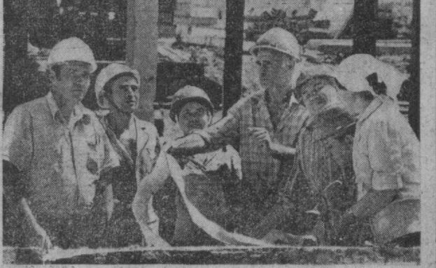
По методу Злобина работает на реконструкции Ташкентского тракторного завода комплексная бригада Л. Бишопа из передовой механизированной колонны № 126 треста «Таштрансторстрой». По итогам работы за второй квартал текущего года она признана победительницей. В минувшей пятилетке бригада выполнила десять годовых заданий. На снимке слева направо: члены бригады плотник Р. Сайфуллин, бетонщик З. Амиров, маляр Т. Галеева, зам. бригадира Э. Вундер, каменщик А. Салихов, арматурщик Д. Лянг, штукатур М. Камалова. Фото В. МОЛГАЧЕВА.
