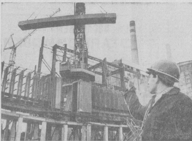
На снимке: монтаж перекрестий машинного зала под 5 и 6-й блоками. На переднем плане — монтажник Мирсан Асиянов. Фото Л. ГУСЕИНОВА.
