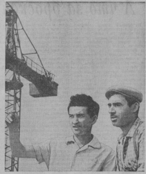
Панорамный кинотеатр — юбилейная стройка Ташкента. Строители стремятся сделать так, чтобы кинотеатр распахнул свои двери в канун 40-летия республики и Компартии Узбекистана. На снимке: Мастер передовой участка инженер Салим Якубовичев (слева) дает задание вожаку комплексной бригады Уриелу Абаеву.
