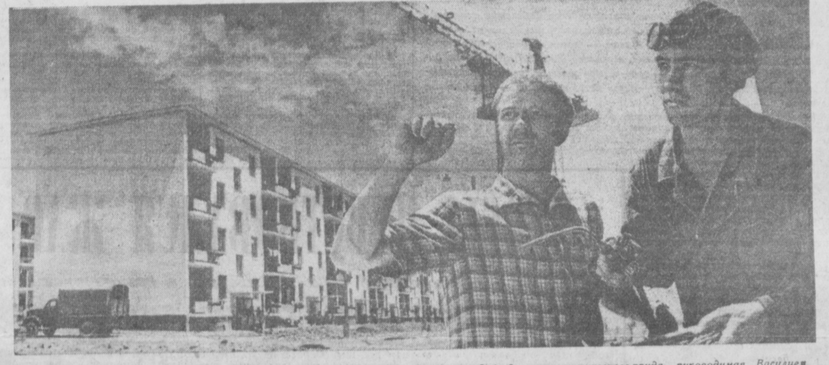
Отлично трудятся на строительстве домов в секторе 7 «б» массива Чкаловград бригады коммунистического труда, руководимая Василием Михайловичем Первухиным. Дома сдаются в эксплуатацию по гарантийному паспорту. На снимке: бригадир В. М. Первухин беседует с газосварщиком Бахтияром Абдуллаевым, ведущим сварку конструкций. Фото В. Косовского.
