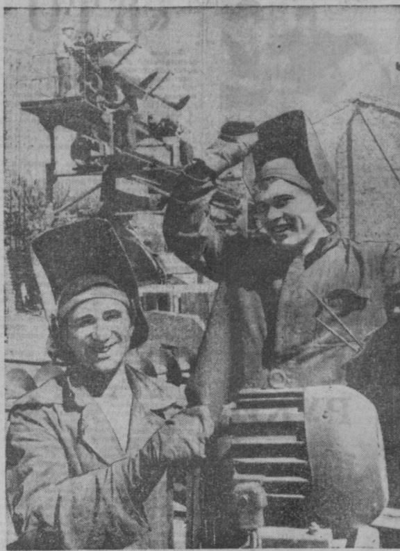
В Самаркандской области завершается строительство Чарчинского хлопкоочистительного завода. На снимке: передовые монтажники Ибрагим Мухтаров (слева) и Федор Попруз. Став на вахту в честь сорокалетия республики и Компартии Узбекистана, они выкладывают по полторы производственные нормы за смену.
