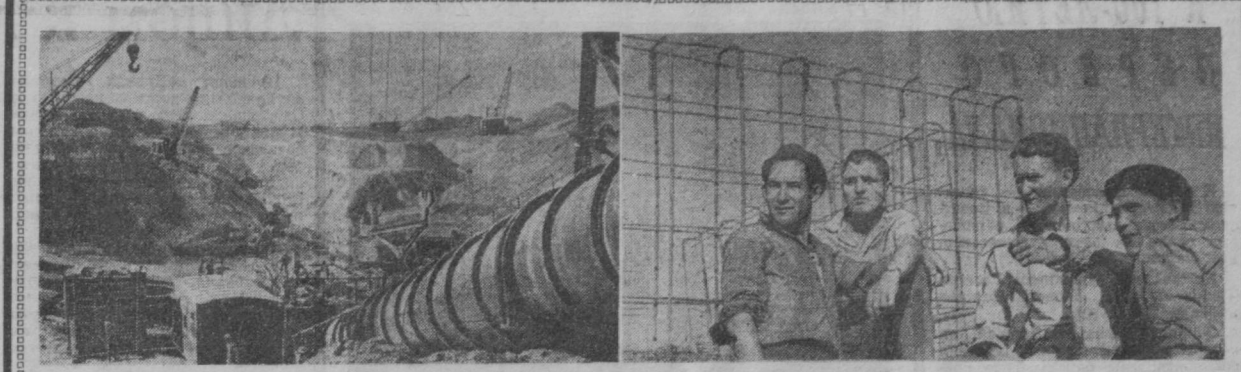
Днем и ночью продолжают работы на строительстве Аму-Бухарского канала. На снимках: на строительной площадке Кумызарской насосной станции; передовая бригада арматурщиков (слева направо): Фарид Мурадинов, бригадир Василий Стужук, Марс Давидов и Юрий Рачук.
