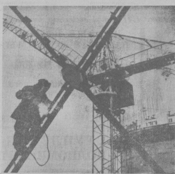
Огни сварки... Своими короткими, яркими вспышками они освещают строительную площадку, где сооружается Ферранский аэрокосмический завод. Воздушные военные великими задачами построения коммунизма, изложенными в проекте Программы КПСС, строители решили ко дню открытия съезда партии завершить сооружение объектов первой очереди, а к концу года довершить сдать ее в эксплуатацию.
