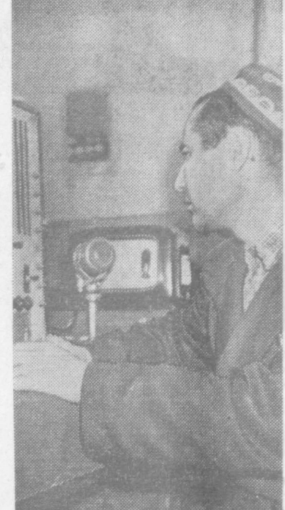
На нефтепромысле «Паванташ» закончилась автоматизация откачки нефти из главных резервуаров в центральный нефтепромысел. Моторы, приводящие в действие насосы, пускаются и выключаются с центральной пульты управления. Теперь все основные процессы добычи газа и нефти на промысле автоматизированы. ИА СНИМКЕ: старший диспетчер Инам Юсупов и пульты управления.
