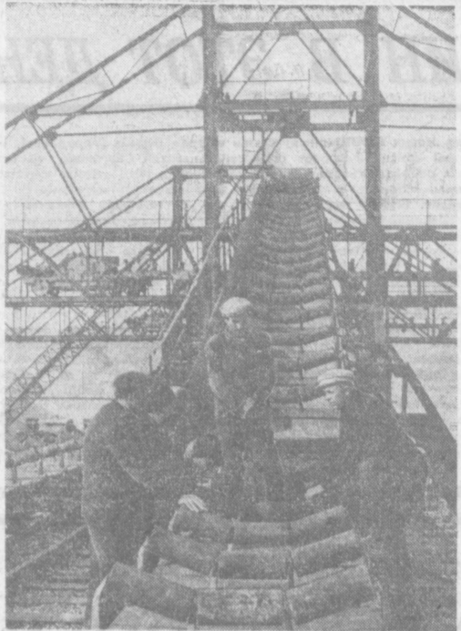
На этом снимке В. Кузнецова и А. Кличиннова вы видите штабелеуладчиков, впервые в СССР примененные на Андриановском водохранилище. Они предназначены для укладки сортированных инертных материалов в штабеля.
