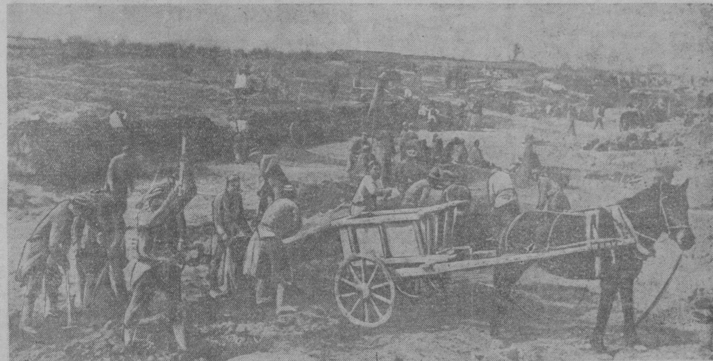
Общий вид работ на 2-м участке строительства Ташкентского канала, где работают колхозники артели им. Ахунбабаева, Орджоникидзевского района. Фото М. Пенсона.
