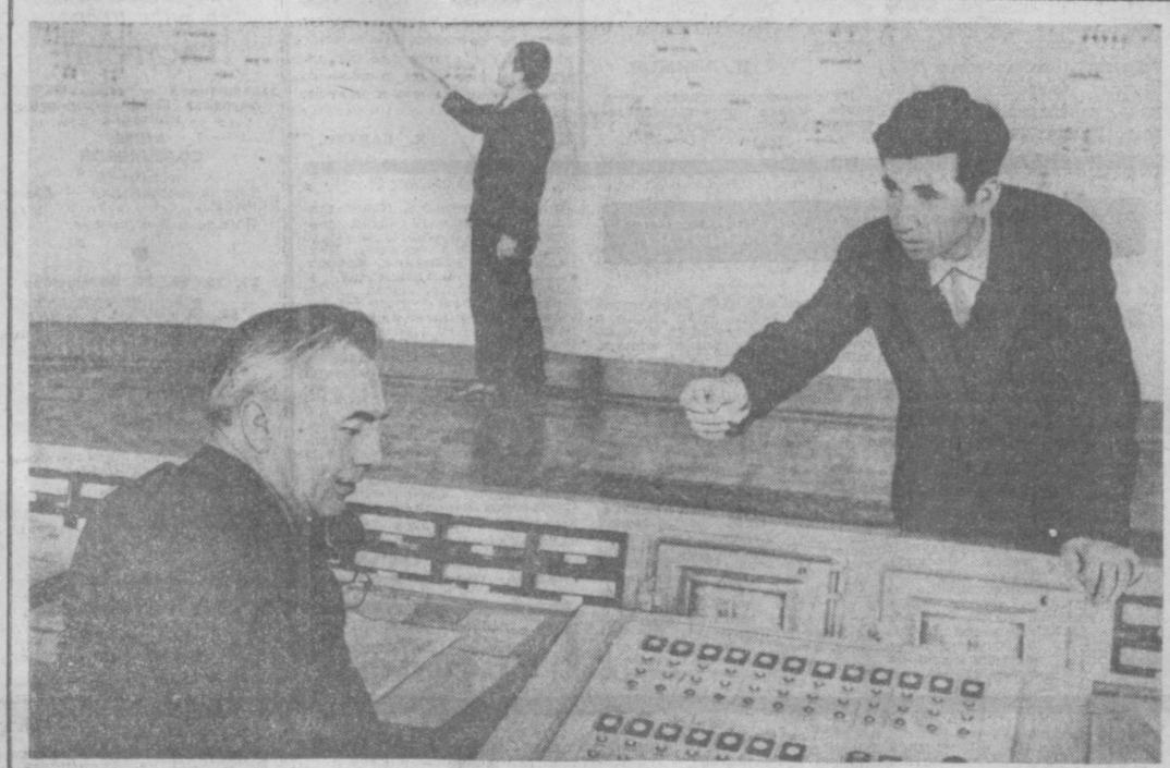
Центральный диспетчерский пункт Узбекской энергосистемы. Отсюда осуществляется оперативное управление всеми электрическими станциями и подстанциями, подачей энергии во все концы республики. На снимке: дежурные инженеры Э. Мухамедшин, А. Сайфитдинходжаев и В. Чапурин. Фото Н. ГЛАУВЕРЗОНА.
