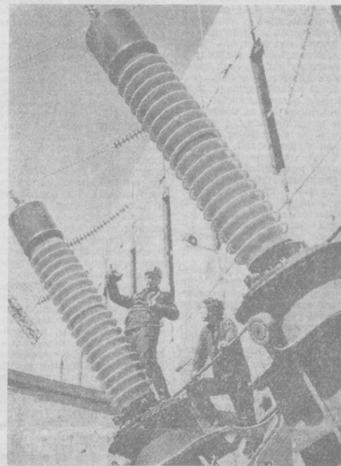
Это трансформатор второго генератора Чарвакской ГЭС. Сейчас здесь хозяйничают электромонтеры из бригады трансформаторщиков Романа Сиразидинова. Последние «штрихи» перед вводом в эксплуатацию. Через несколько дней с клемм трансформатора потечет «электрическая река», которую начнет вырабатывать второй гидроагрегат Чарвака.
