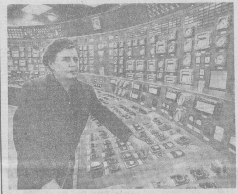
Ташкентская ГРЭС полностью вступила в эксплуатацию. Ее двенадцать энергоблоков дают около двух миллионов киловатт электроэнергии. На снимке: лучший машинист электростанции Василий Завлиничев. Фото И. ГЛАУБЕРЗОНА и В. СИРОТКИНА.
