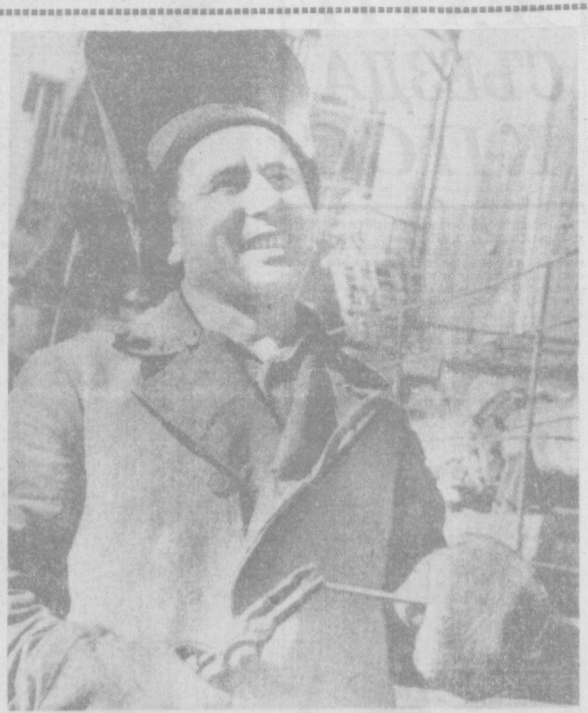
Самаркандский суперфосфатный завод наращивает мощность. Сейчас здесь ведутся работы по реконструкции сернокислотного цеха. Отлично трудится на объекте бригада монтажников, руководимая Н. Морозовым. Она выполняет наиболее ответственные задания. На снимке: один из лучших электросварщиков бригады И. Тынчеров.
