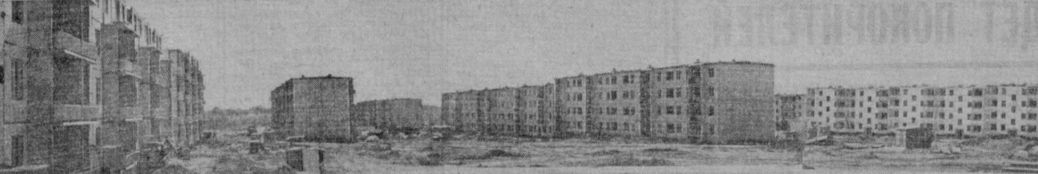
Ташкентские строители наращивают темпы ввода в эксплуатацию новых многоквартирных жилых домов для вселения в них пострадавших от землетрясения семей. Многие коллективы строителей перешли на работу в три смены. Работники монтажного управления №1 Ташкентского домостроительного комбината взяли повышенное обязательство — смонтировать в мае шестнадцать сорокакомнатных жилых домов в шестнадцатом квартале Чиланзарского массива.
