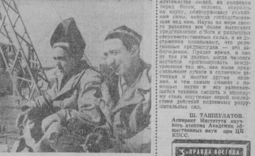
В восточной части площади Регистан в Самарканде строится широкоэкранный кинотеатр на 850 мест. На этом снимке вы видите передовых электросварщиков-монтажников Анатолия Мищенко и Михаила Кривошеина, занятых на стройке.
