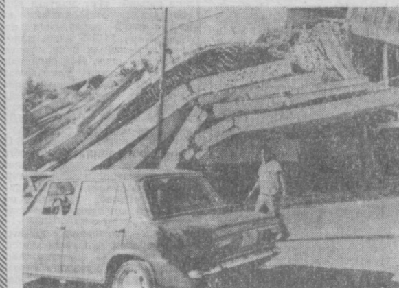
Яқинда Никарагуа поитахти Манагуа шаҳрида қаттиқ ер қирқилди. Минглаб одамлар бошпанасиз қолди, бир неча кварталлар харобабга айланди. Суратда: ер силкингандан сўнг шикастланган турар-кой биноларини кўриб турибсиз.
