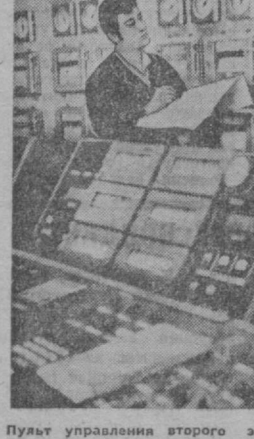
Пульт управления второго энергоблока.
