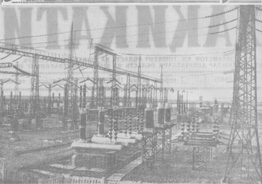
Олмалиқда янги электр подстанцияси ишга туширилди ва у Ўзбекистон, Тожикистон ҳамда Қозғоғистон ағона энергетика системаси ҳалқисига уланди. Бу подстанция тўла ишга туширилгач қардош республикалардаги қолхозлар, совхозлар ва саноат корхоналарини электр қуввати билан таъминлаш яхшиланади.
